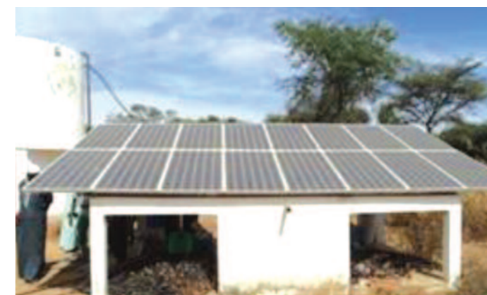
Figure 3 : Plaque solaire pour l'irrigation des parcelles maraîchères
